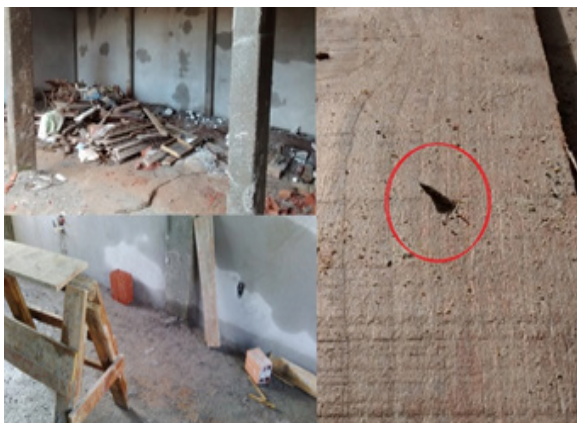
FIGURA 4 - Madeiras espalhadas no canteiro de obra
