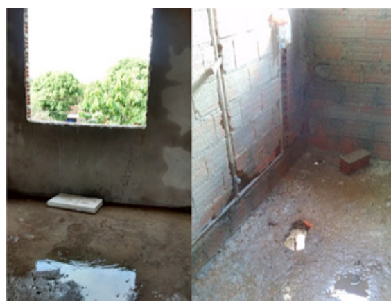
FIGURA 6 - Acúmulo de água na obra
